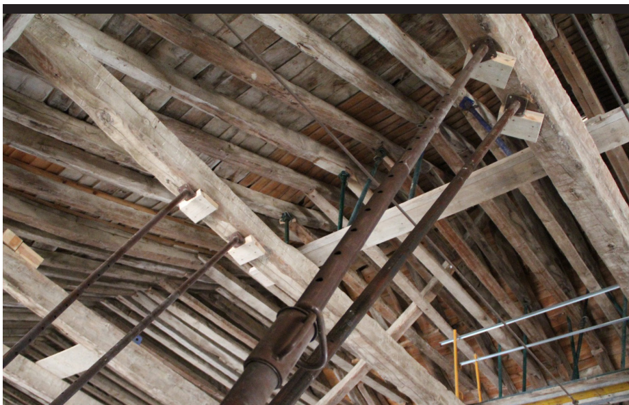
Estado inestable de las vigas y la estructura general de la cubierta
